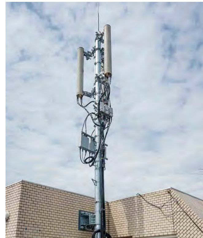
通信基地局柱
